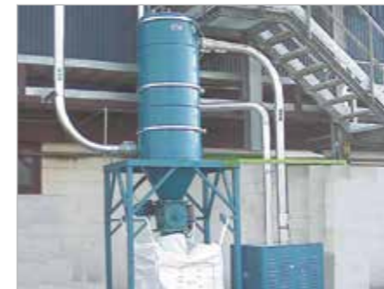
中央气泵 Central air pump
